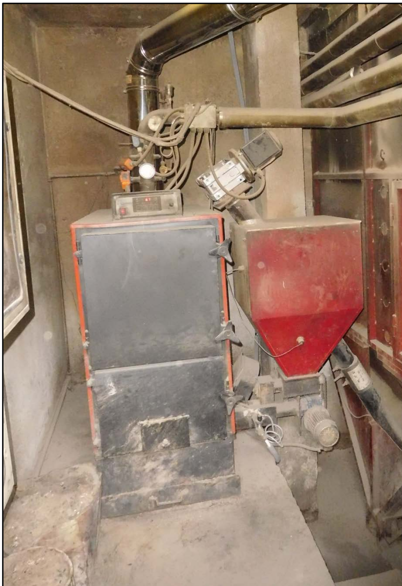
Figura 5: Generatore di calore esistente
