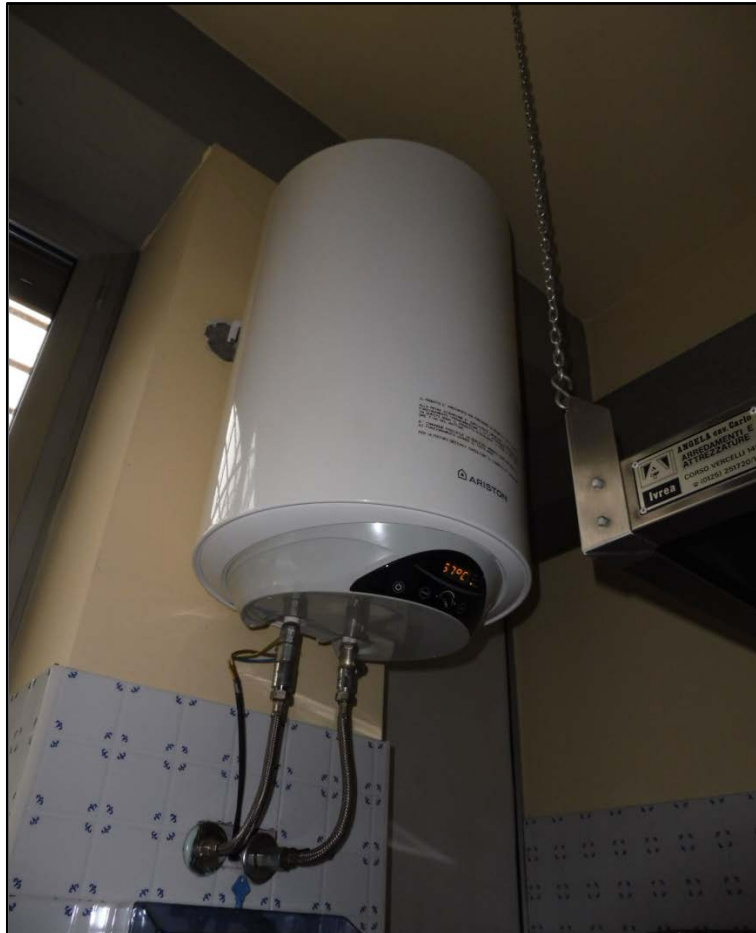
Figura 14: Boiler elettrico locale cucina
