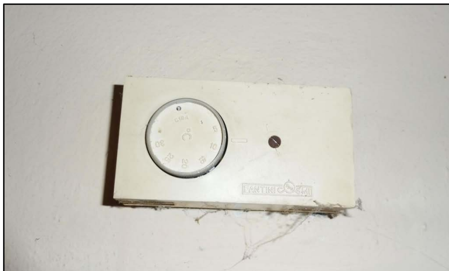
Figura 13: Termostato locale proloco
