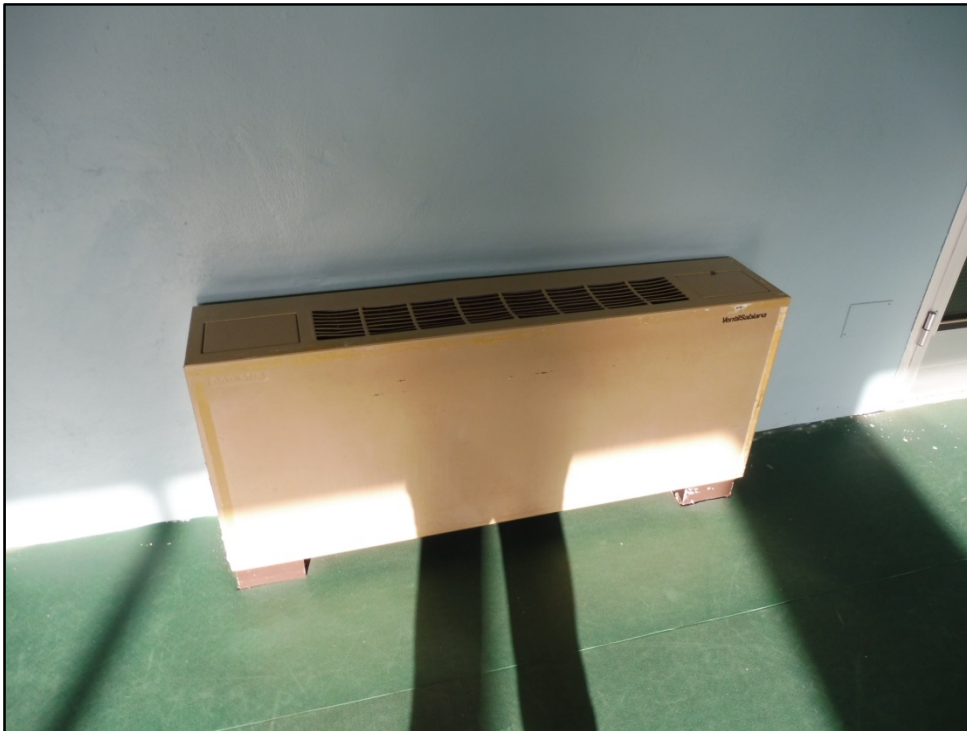
Figura 11: Ventilconvettore a pavimento locale palestra
